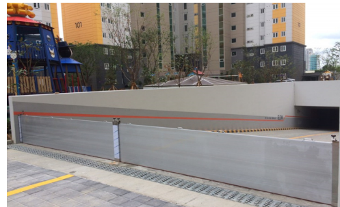
〈울산아파트 지하주차장 차수판 3) 〉
